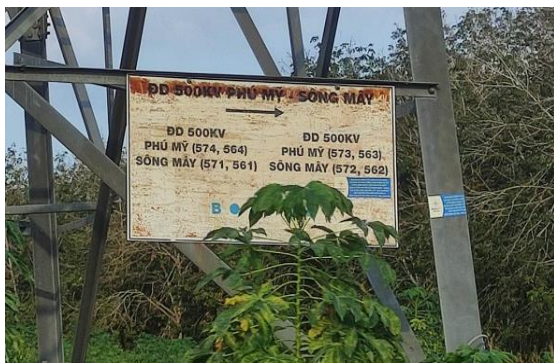
500kV (Phú Mỹ - Sông Mỹ)
